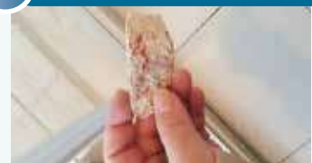
3 施工前 - 石材晶體剝落塊狀
