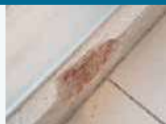
2 施工前 - 石材門檻晶體剝落
